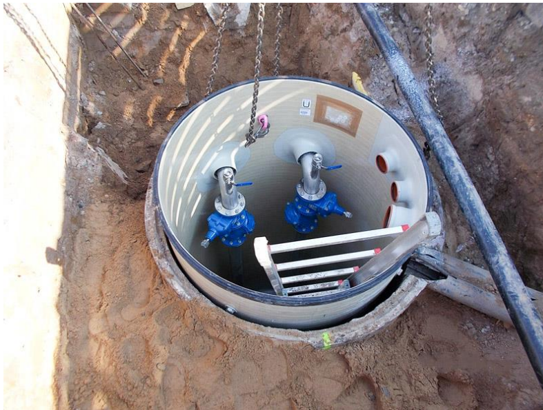
Das als „Schacht-im-Schacht-System“ gefertigte neue Pumpwerk in Monheim
